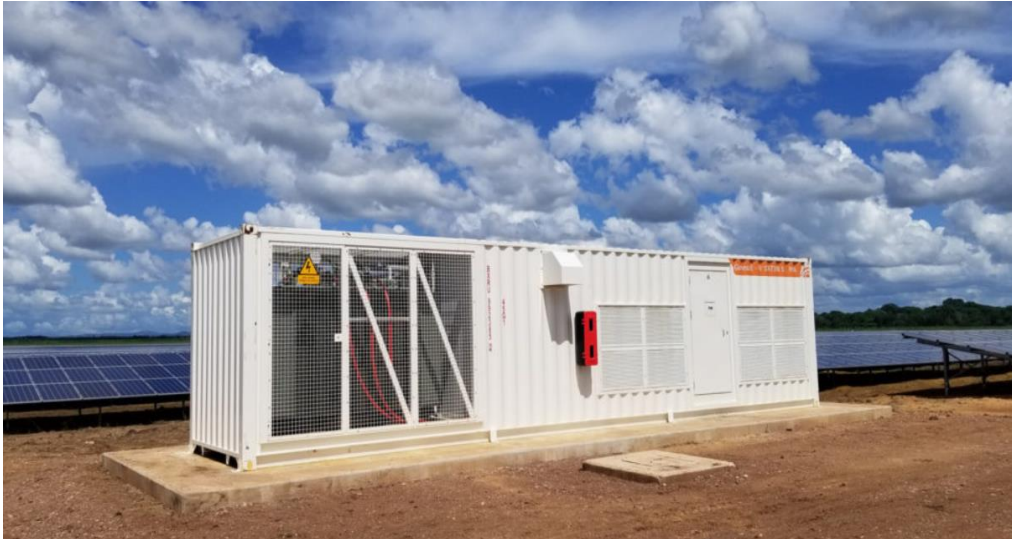
Slika 8. Primjer izmjenjivača, Gamesa Electric PV Station 5.000
